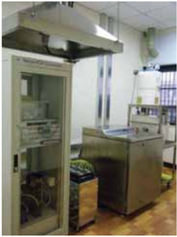
圖2 2kW燃料電池發電系統
