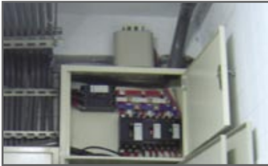
配電系統採用低壓進相電容器 提高功率因數，改善線路壓降
