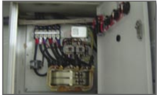
供電電壓偏高者，導入電壓調整省電控制器
