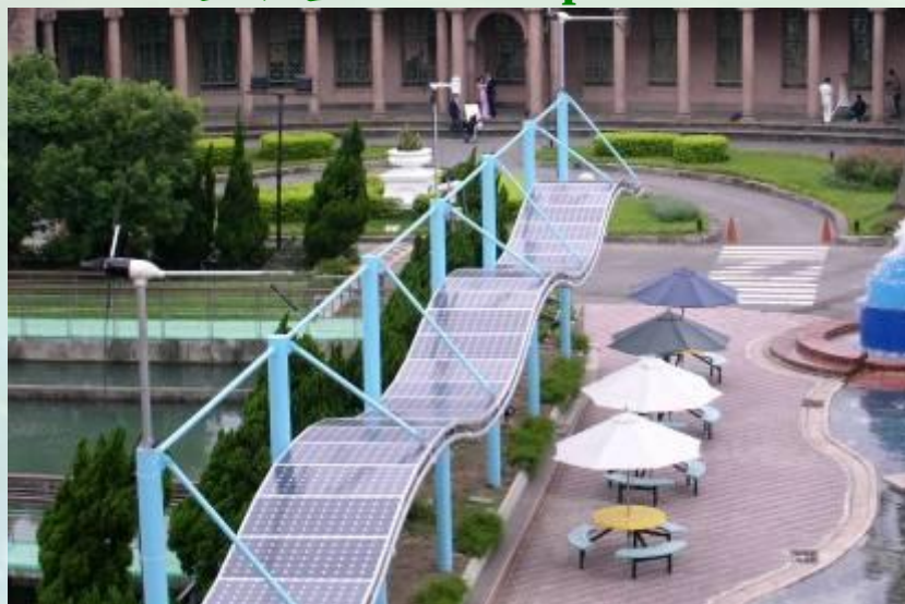
台北自來水事業處 設置容量：6.48kWp
