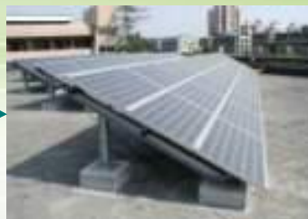
太陽電池組列 (PV Array)
