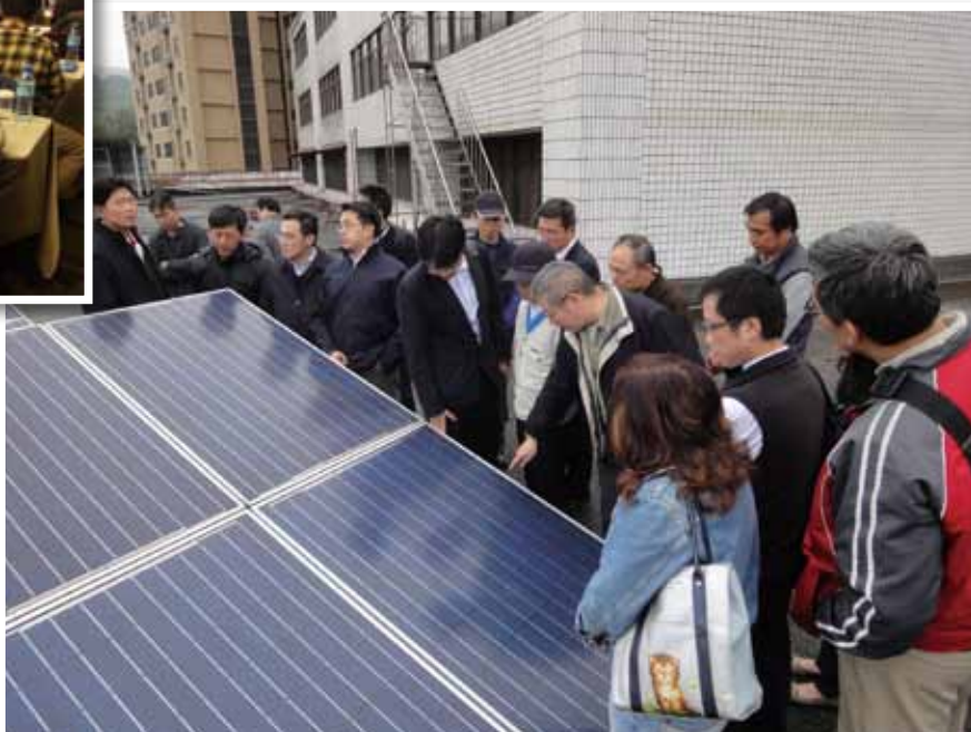
▶ 太陽能光電發電系統現場觀摩情形。
