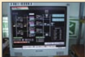
監控空調冰水主機合理化運轉
