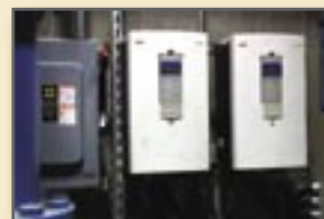
冷卻水塔風車、區域冰水泵 採用變頻器控制
