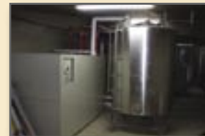
冷凍冷藏主機之熱回收供應熱水 使用
