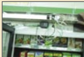
展示櫃玻璃門除霧利用電容式濕 度偵測器
