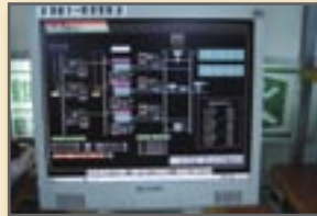
監控空調冰水主機合理化運轉
