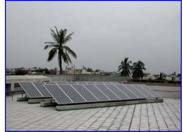
屏東縣公館國小3.5 kWp
