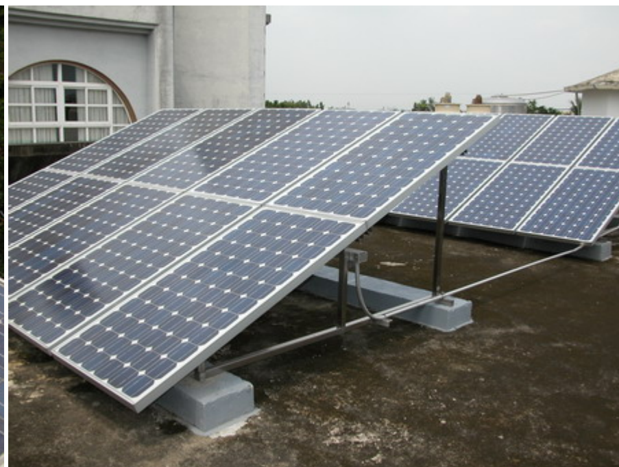
屏東縣萬巒國中 4kWp
