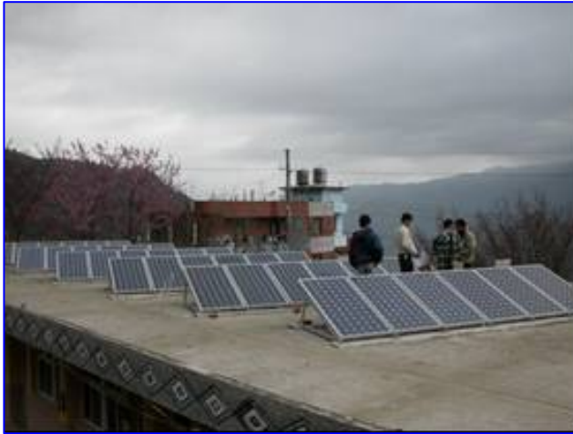
新竹縣尖石鄉鄉公所6.12kWp
