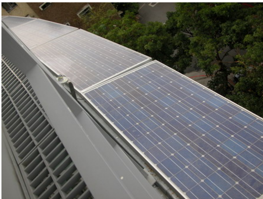
台北市立圖書館—石牌分館 8.64kWp
