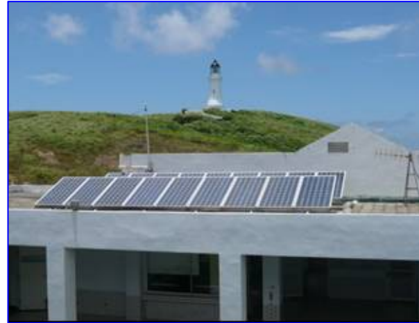
行政院海岸巡防署海岸巡防總局3.06kWp
