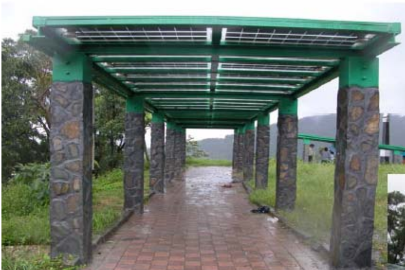
屏東縣三地門鄉地摩兒公園 8kWp
