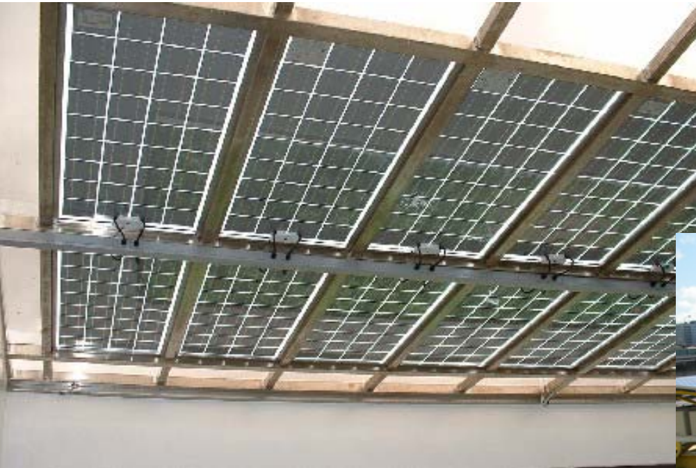
台北縣八里鄉個人住宅 2 kWp 併聯型PV發電系統
