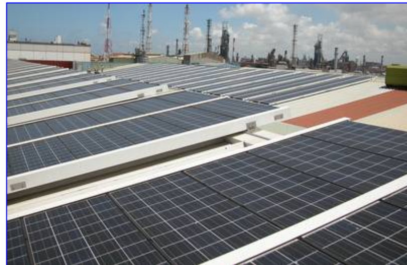
壹東實業公司 高雄市208kWp
