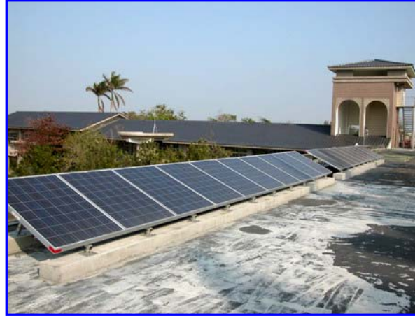
高雄縣桃源國中3.5 kWp
