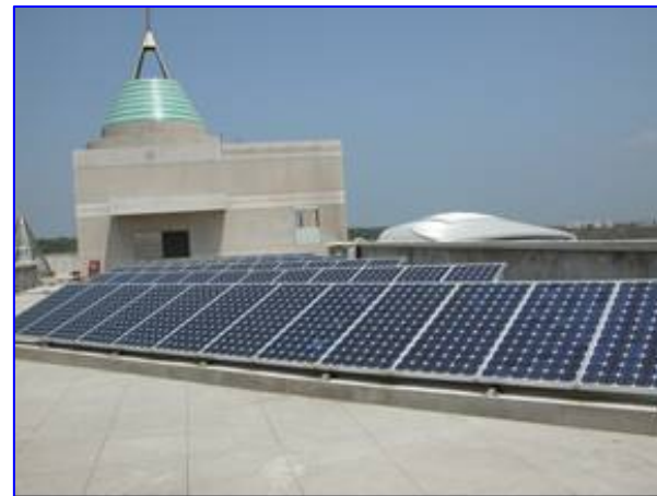
澎湖縣環境保護局6.12kWp
