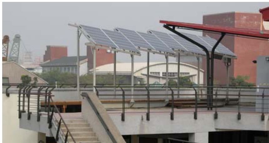
台南縣紅瓦厝國小 4kWp
