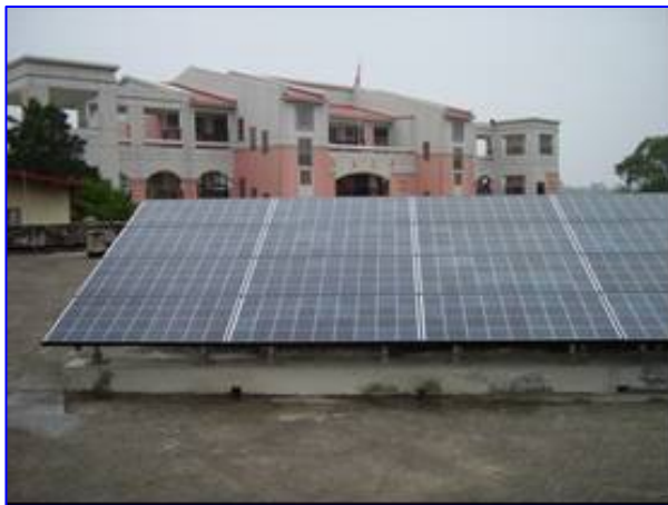
金門縣金寧鄉金鼎國民小學6kWp
